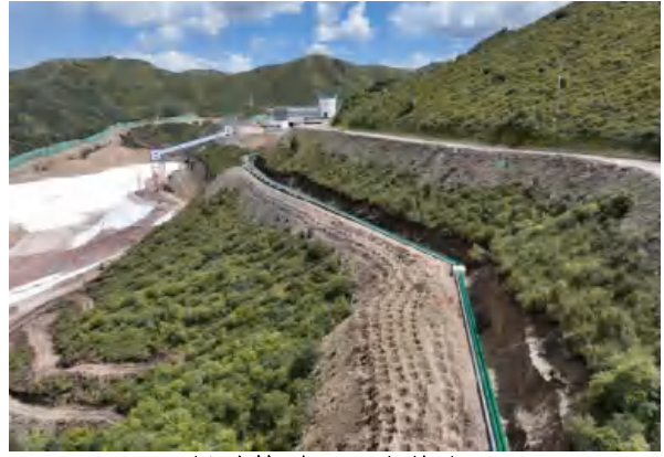
尾矿输送及回水管线
