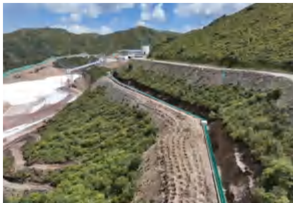
尾矿输送及回水管线
