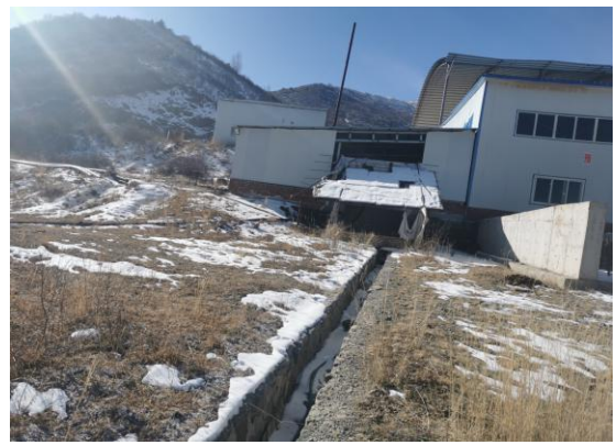
工业场地排水沟
