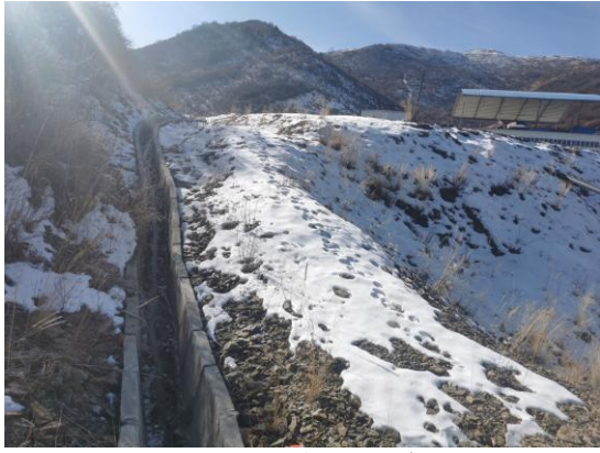
工业场地排水沟
