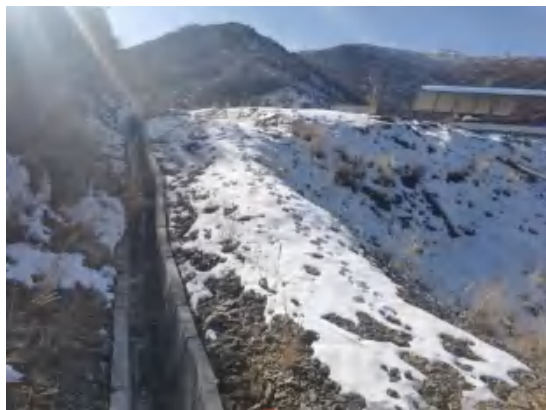
工业场地排水沟
